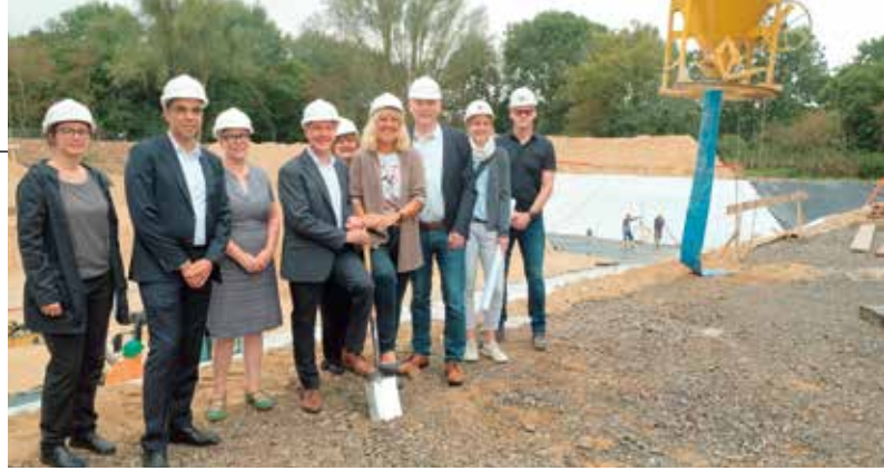
Bürgermeisterin Gisela Klaer und ihr Kerkener Amtskollege Dirk Möcking (mit Spaten) machten im Beisein von Schulleiterin Regina Lingel-Moses, Schulamtsleiter Jürgen Maas, den Architekten sowie Vertretern der Verwaltung den offiziellen Spatenstich. Foto: Stadt Krefeld
